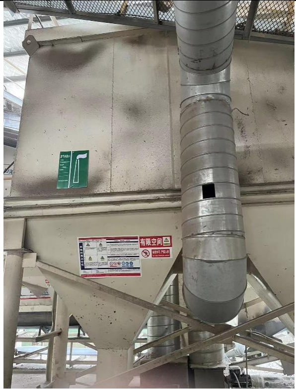
建筑垃圾破碎线除尘器
