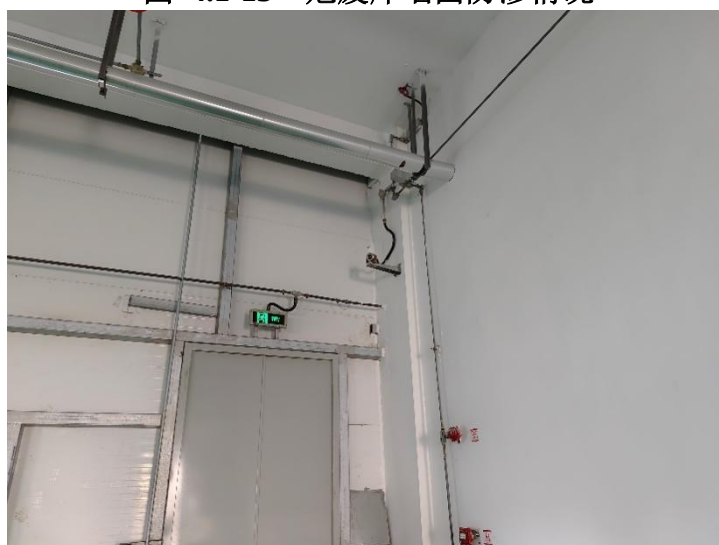
图 4.1-14 危废库监控设施情况
