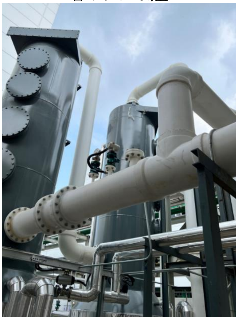
图 4.1-7 预处理碱洗塔
