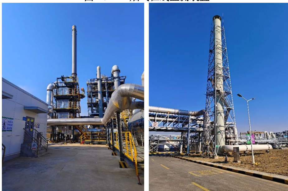
图 4.2-3 本项目废气排气筒（左 DA013、右 DA012）
