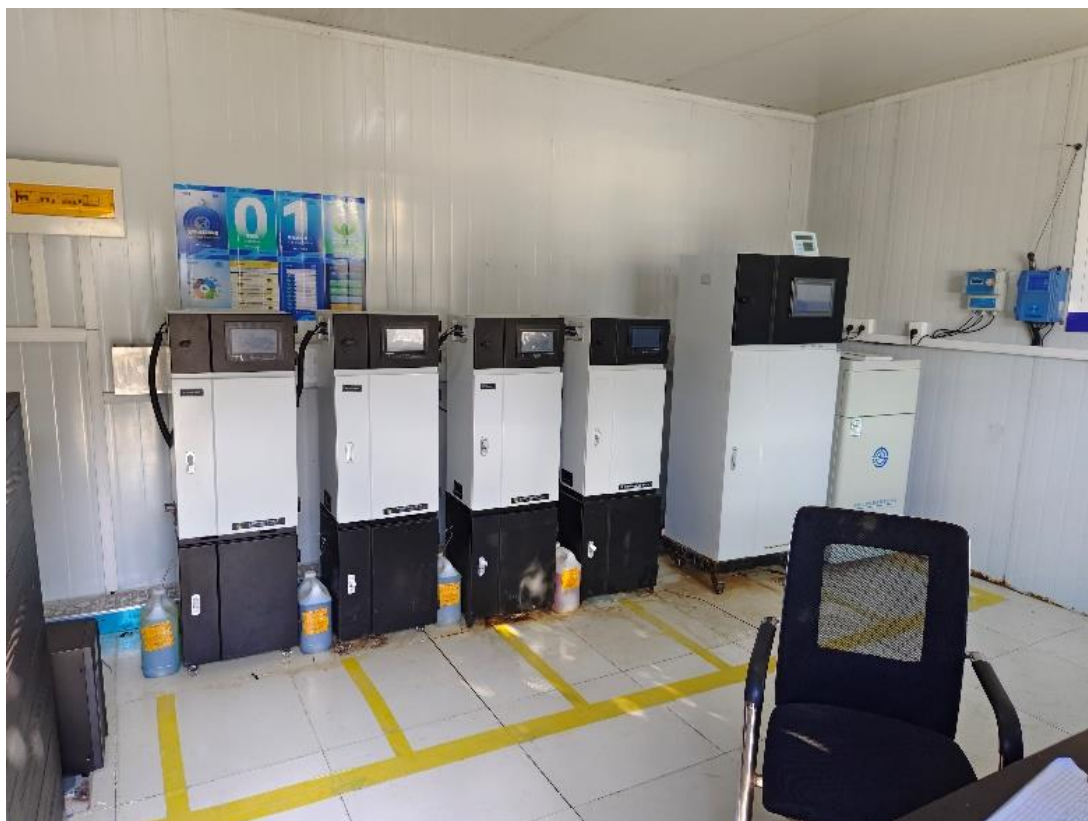
图 4.2-1 废水在线监测设施
