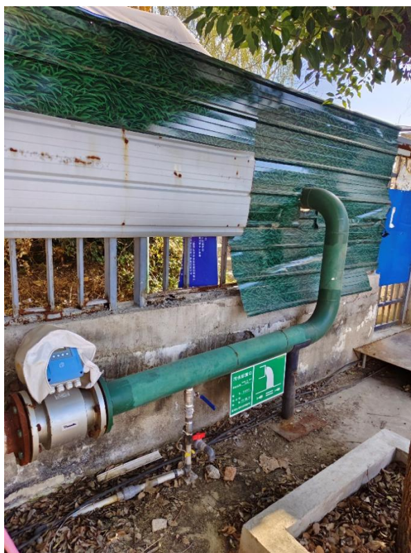
图 4.2-4 废水排放口标识牌
